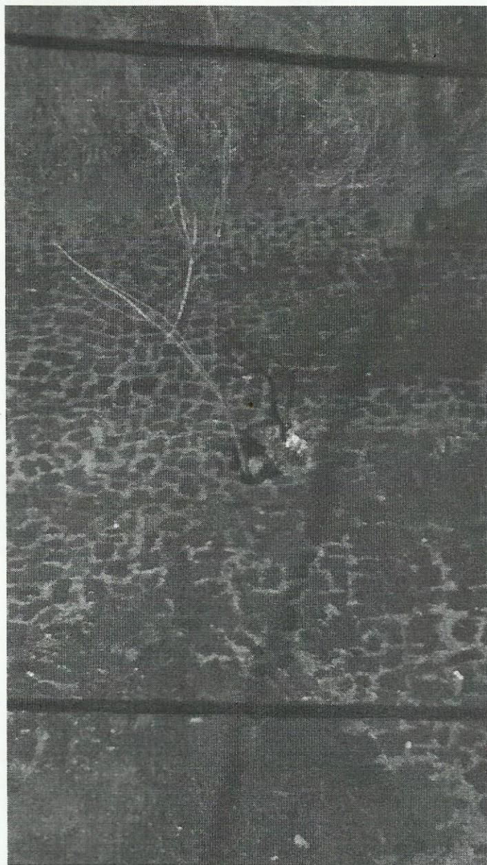
FOTO ILUSTRATIVA, BURACO ESTÁ MAIOR.
