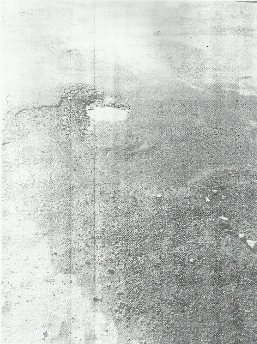
Buraco em frente ao número 725 na Rua Antônio Fernandes da Cunha.
