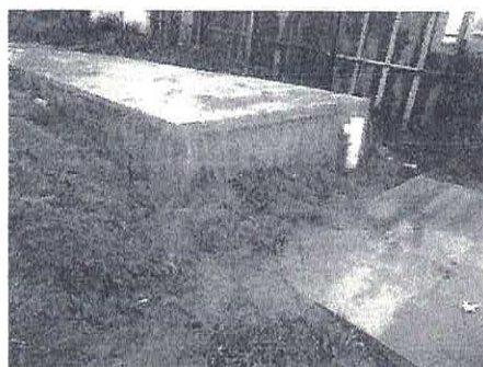
Figura 1- vista parcial da ETE com extravasamento.
