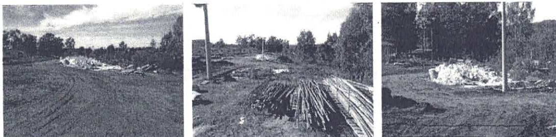
Imagens 1,2 e 3: Se observa o armazenamento inadequado de resíduos sólidos da obra.
