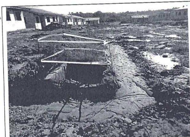
Figura 4 - Dispositivo de drenagem na Rua B.
