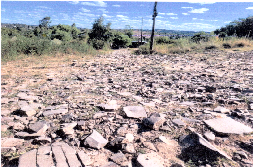
Situação crítica da Rua Jorge Souto Duarte (início).
