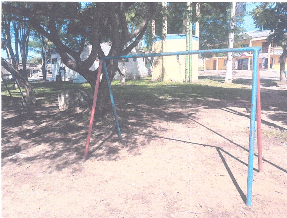
Foto 03 - Tirada em janeiro de 2025. Estrutura de balanço da pracinha da Caixa d'Água. Equipamentos ausentes e com pintura desgastada.
