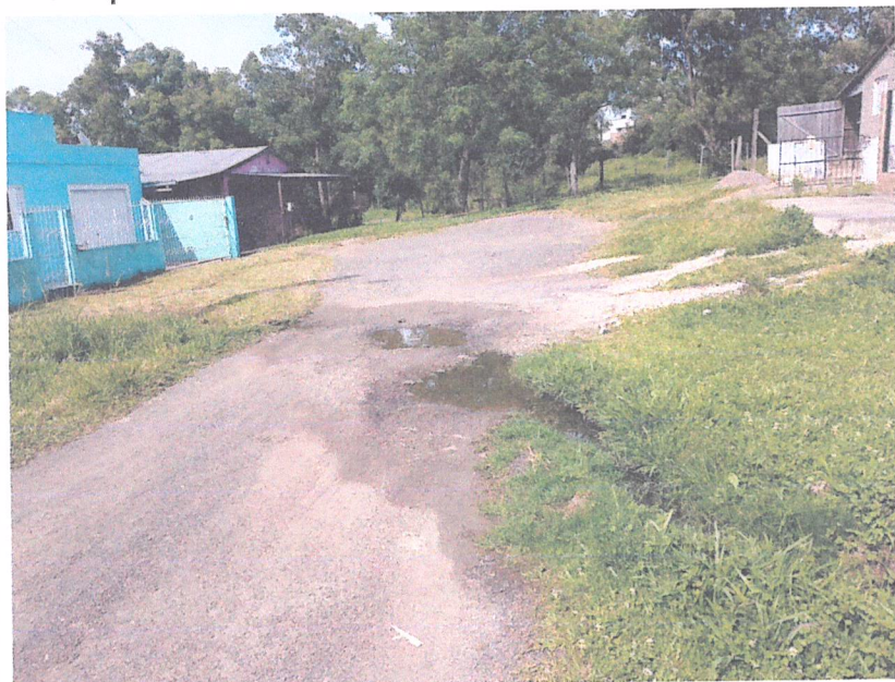
Foto 01 - Tirada em janeiro de 2025. Rua Reverendo Frederico Martins. Ausência de pavimentação e acúmulo de água proveniente de esgoto.
