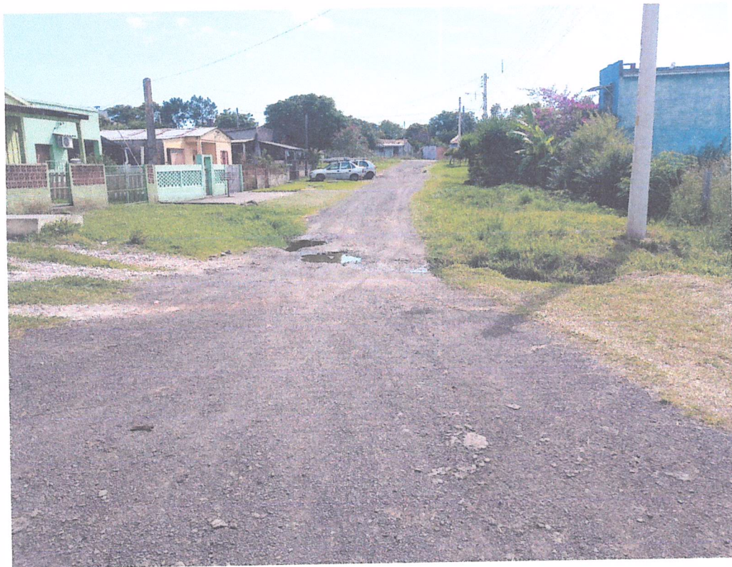
Foto 03 - Tirada em janeiro de 2025. O piso é irregular, formando poças de água na via, indicando falhas no escoamento ou drenagem do esgoto. Esse problema contribui, entre outros fatores, para a proliferação de mosquitos e outras pragas.
