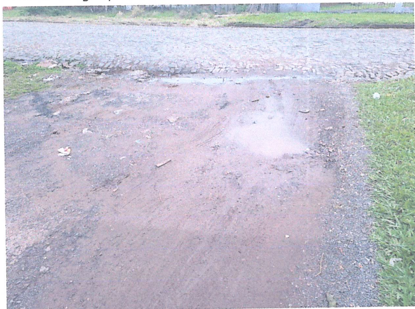
Foto 02 - Tirada em junho de 2025. Acesso a entrada da via. Há buraco e acúmulo de água.
